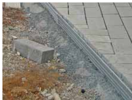
Universität Bamberg: Das Pflaster im stark frequentierten Mensabereich wird durch Gartenprofil und eine einseitige Rückenstütze gehalten.
